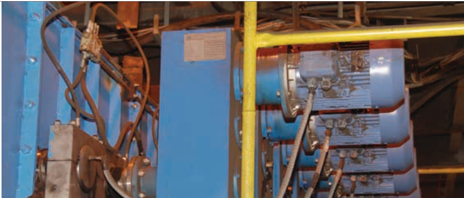
■ Постројење за издвајање комадног угља
